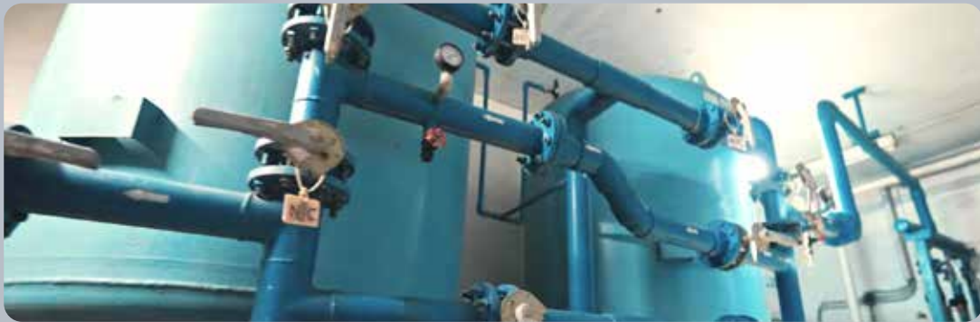
Gambar 19. Fasilitas Sewage Treatment Plant yang dimiliki Telkom Group
