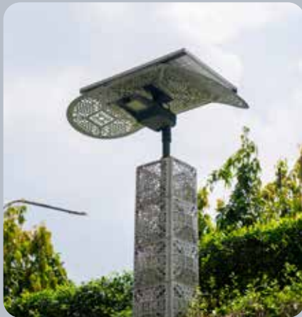
Gambar 12. Penerangan jalan umum dengan teknologi panel surya
