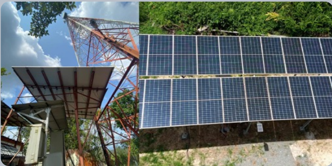
Gambar 10. Menara BTS dengan panel surya
